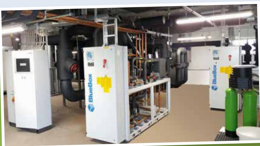
◀ Neue energieeffiziente Kälteanlage im BioTechPark
